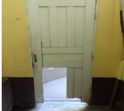
5-Porta quebrada - CDC
