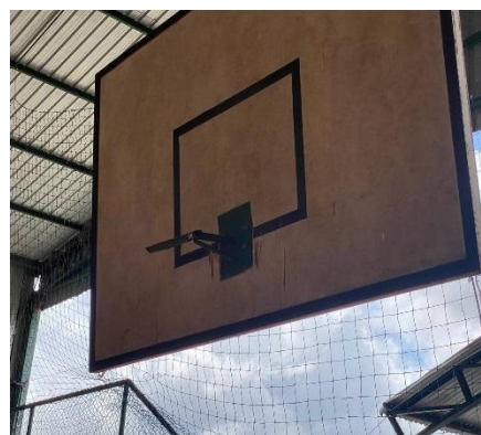
3-Quadra esportiva coberta – cesta avariada
