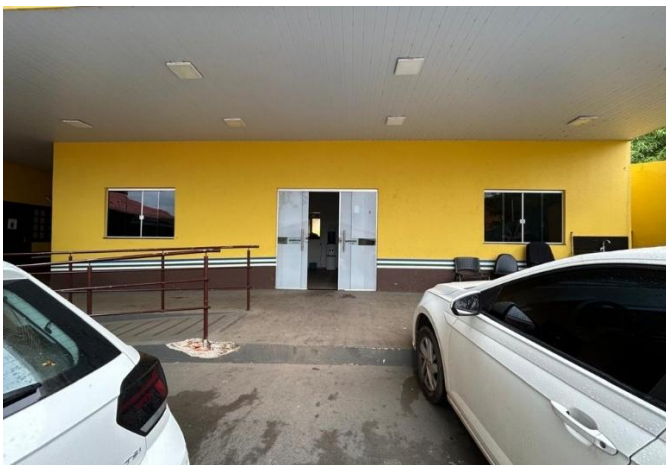
1-Desnível entrada Gabinete
