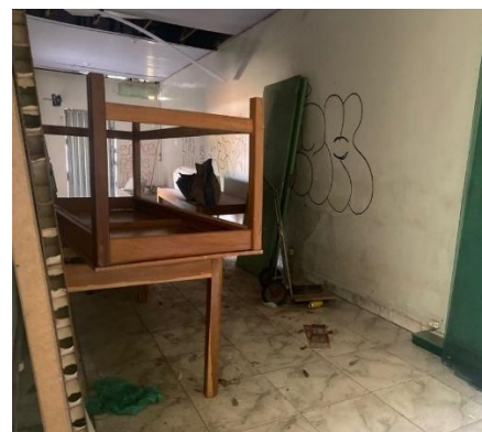
3-Degredação Prédio Antigo Rua 09
