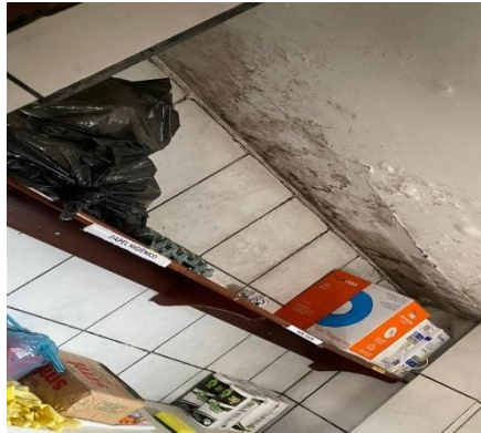
20-Umidade/infiltração Conselho Munic. Saúde
