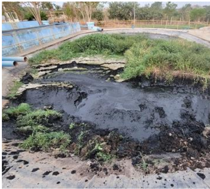
2- Estação de Tratamento de Esgoto WTorres - Câmara Anóxica
