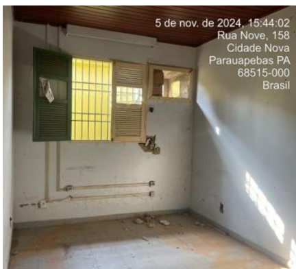
2-Infiltração Prédio Antigo Rua 09
