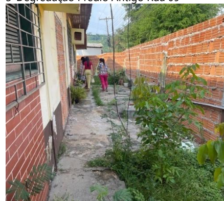
6-Falta de reboco Prédio Antigo Rua 09
