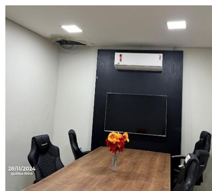
21-Avaria forro e goteira
