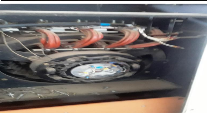
Grupo motor gerador Stemac e seus componentes.
