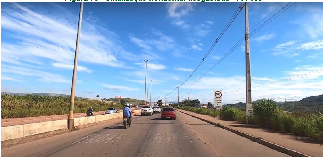
Figura 78 - Sinalização horizontal desgastada - PA-160
